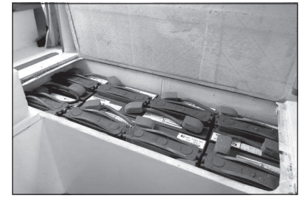
Le groupe de batteries à plomb (400kg) pour stocker l'énergie solaire
